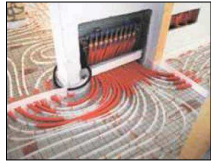
collettore a parete e giunti di frazionamento
